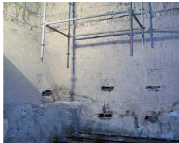
FIRE BOLT®: после 14 месяцев эксплуатации
