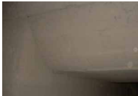
Стояк, футерованный бетоном 561 Denscast SIC 30
