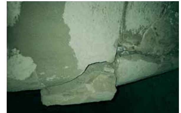
Разрушенная область, возникшая из-за химического воздействия и недостаточного расширения
